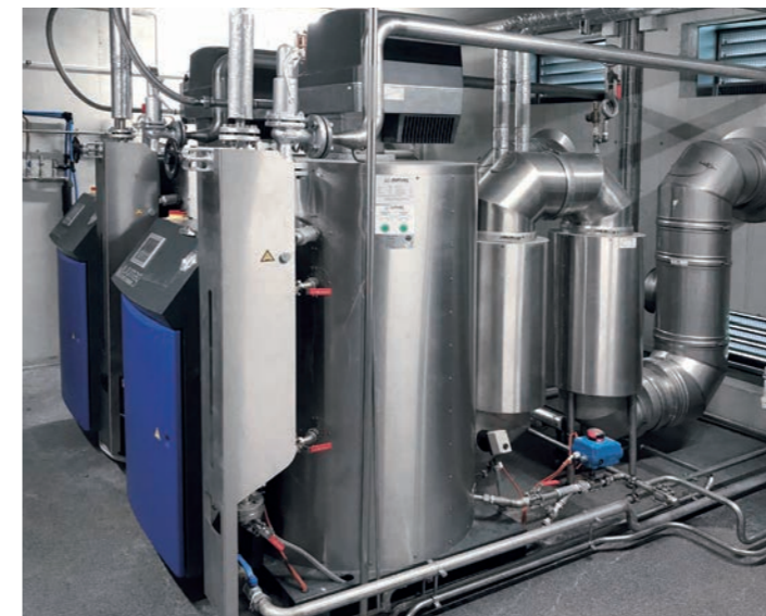
Abb.: Mehrfachdampfanlage. Zweiter nachgeschalteter JUMAG Economiser platzsparend auf Grundgestell installiert
